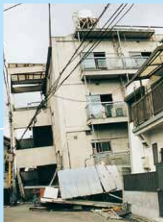
地震による倒壊 (阪神・淡路大震災 1995年)
